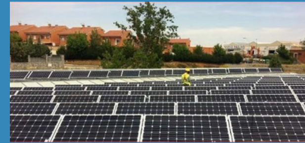
PLANTA FOTOVOLTAICA TOLEDO
